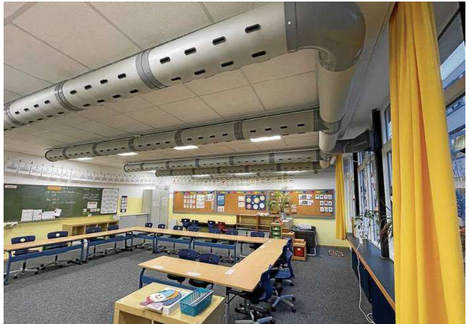
So sieht die Anlage aus, die in einem Klassenraum der Grundschule am Ebersberg jetzt installiert wurde.
